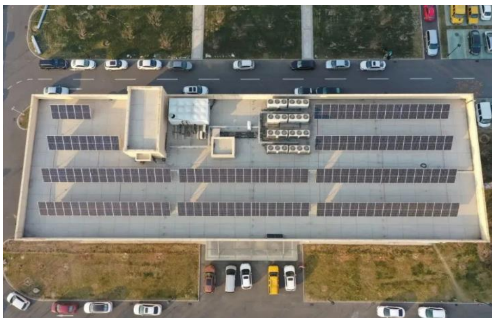
滨州供电公司郭集智慧能源综合示范区的办公区屋顶光伏板
