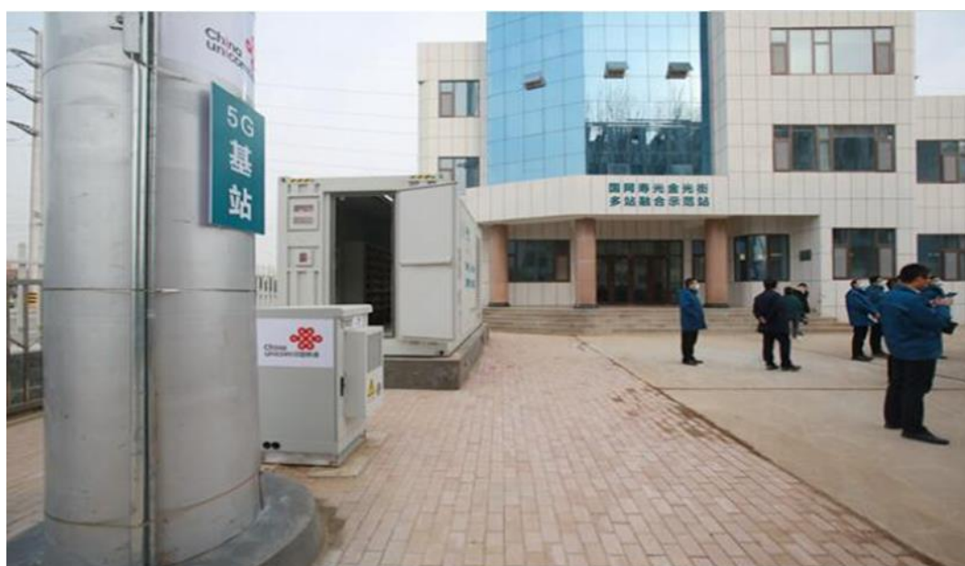
寿光市金光街多站融合示范站
